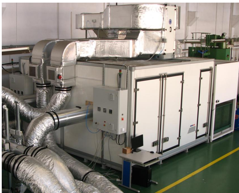
Rys. 1. Widok ogólny stanowiska do badań central wentylacyjnych
